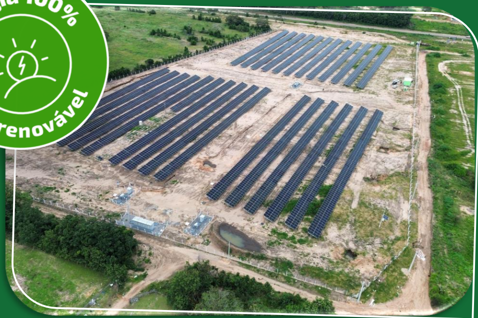
Usina Solar de Comodoro – MT
