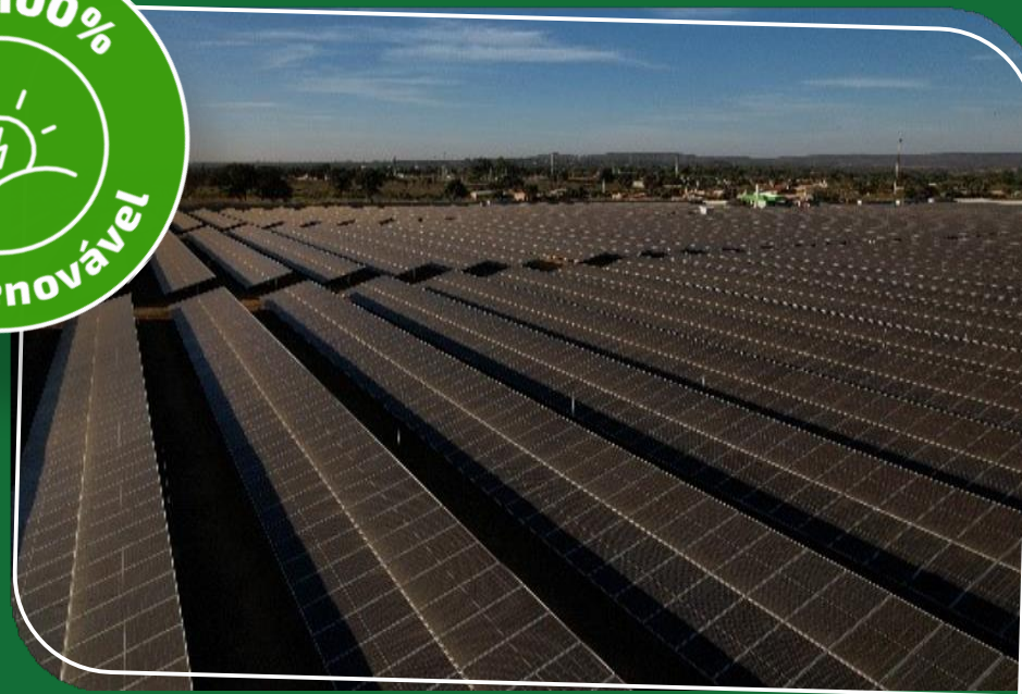
Usina Solar de Nova Xavantina - MT
