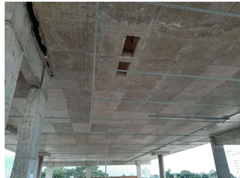
Infra elétrica Teto 3º Pav.
