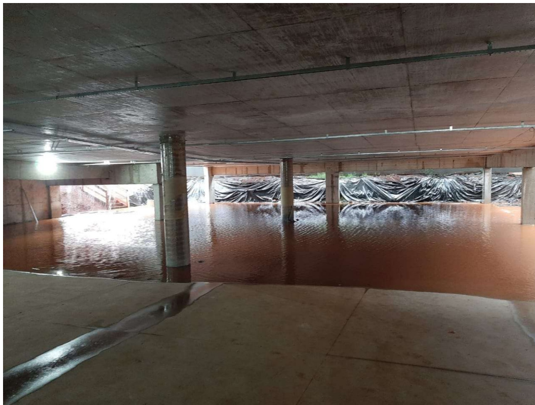
Parte inferior da rampa SS alagada
