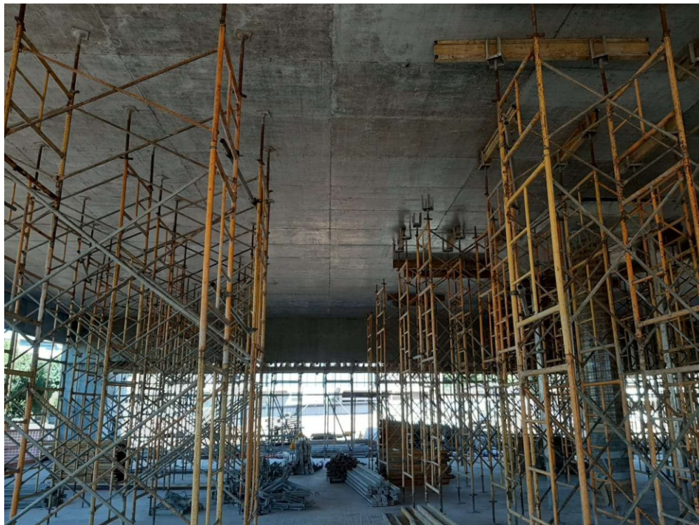
Laje desformada do 2º Pav
