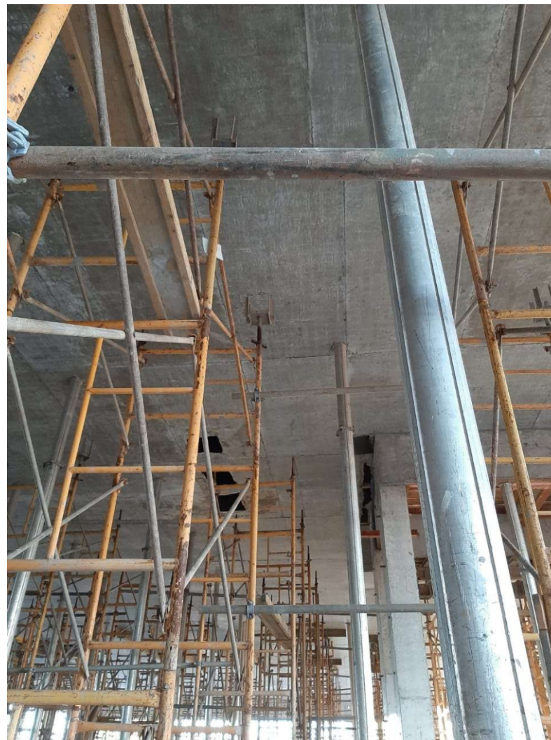
Laje 2º Pav desformada.
